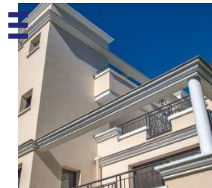
Conception des façades pour éviter les coulures
